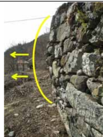
Spanciamento nella parte superiore del muro
