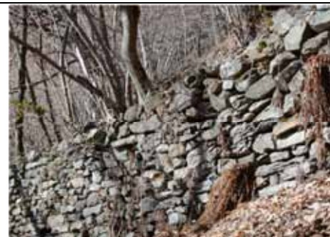
Dislocazione e traslazione in avanti di una porzione di muro, spinto dalle radici di un albero
