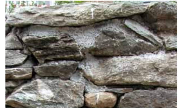
Muro con elementi lapidei allettati con impiego di malta cementizia, che risulta visibile nei giunti e sborda sulle pietre
