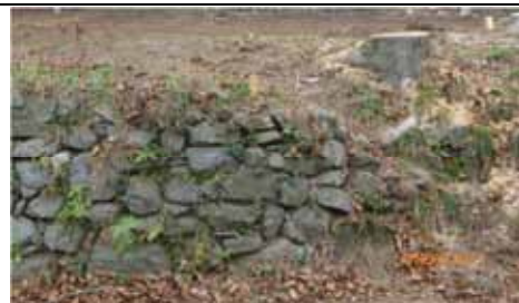
Caduta di pietre e progressivo smontaggio del muro dovuto al passaggio di animali e persone
