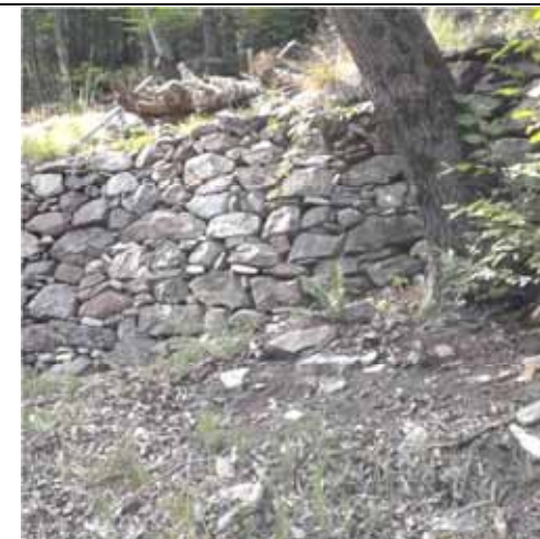
Albero addossato al piede del muro
