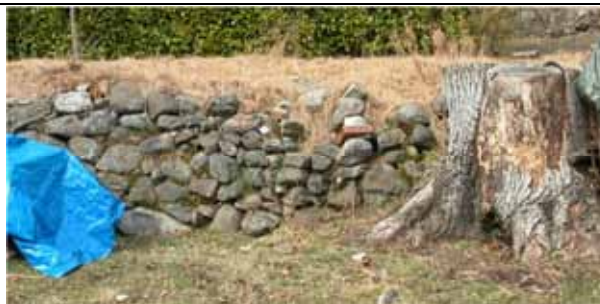
Crollo parziale e incipiente 'smontaggio' del muro, provocato dalla fuoriuscita accidentale di alcune pietre e aggravato dal passaggio di persone e animali
