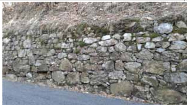
Muretto di contenimento terreno lungo una strada, eseguito con pietre in gneiss della serie kingizitica - Parone
