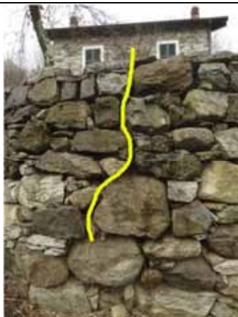
Fessurazione: giunti verticali non sufficientemente sfalsati
