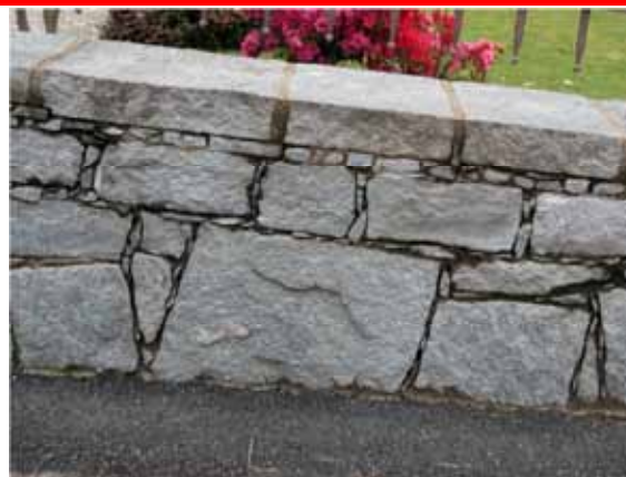
Intasamento di tutti i giunti, anche quelli sottili e regolari con scagliette di pietra; sigillatura delle lastre che costituiscono la copertina di coronamento
